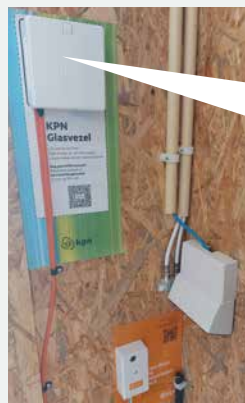
Glasvezel-aansluiting in de meterkast
